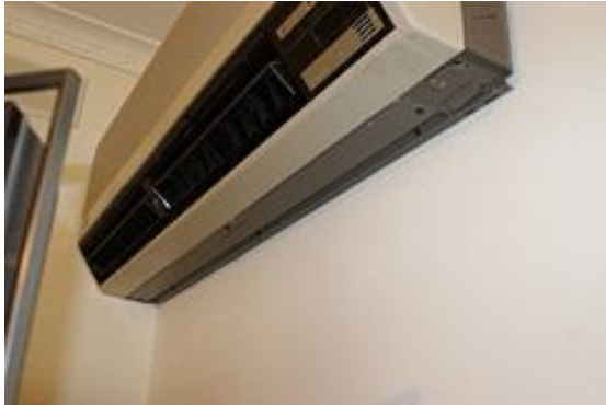
Aire Acondicionado tipo split Foto tomada de: www.flickr.com
